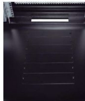
Entrada de cables por suelo de gran capacidad con tapas modulares atornilladas
